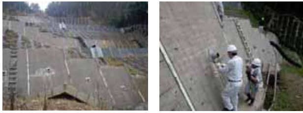
写真-5 のり面の変状状況
